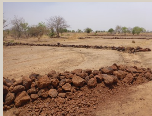
Erosionsschutz und Wasserrückhaltebecken
